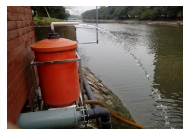
脱氮促生剂在线投加设备
